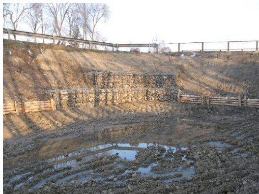
Fontana Bajona: testa del fontanile - gabbionata
